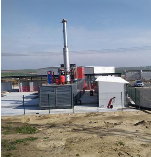
Resim 111 Çorlu Entegre Katı Atık Yönetim Tesisleri
