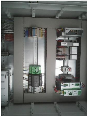
Resim 85 Kütahya Altyapı İzleme Sistemi
